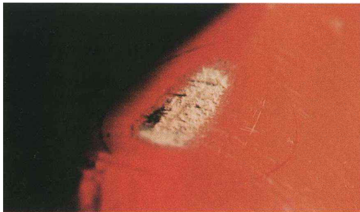
b) 2등급 마모손상 - 두께의 5%~15% 마모손상(수리 및 내압시험 요구됨)
